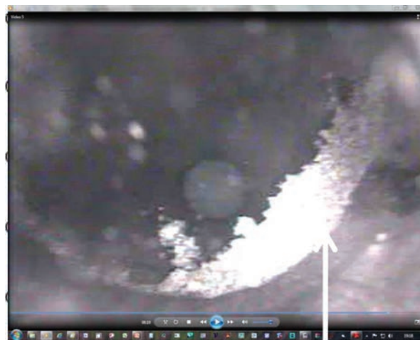
Fig. 4 - Immagine ripresa da telecamera da pozzo di una tubazione rotta in corrispondenza di una giunzione.
