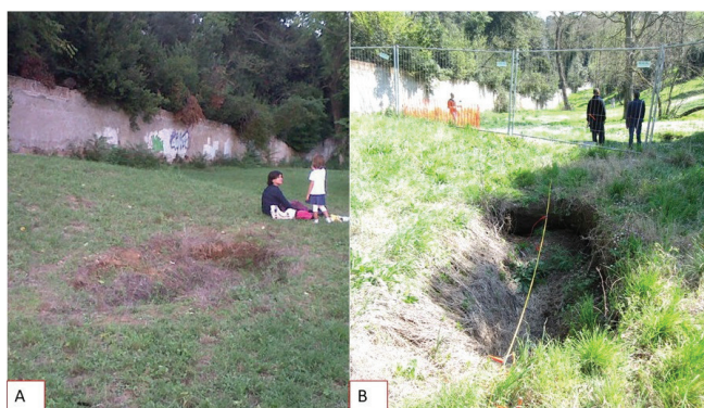
Fig. 3 - Le voragini del Parco Rabin: il primo sprofondamento incipiente osservato nel settembre 2012 (A) e stato del fenomeno nel 2014 (B).
