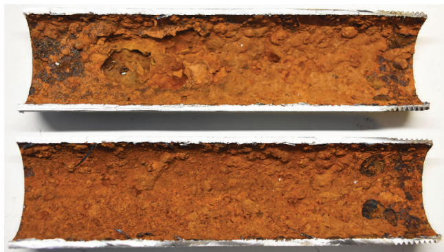
Fig. 6 - Aspetto della superficie interna, sezione longitudinale di tubo tal quale in acciaio al carbonio DN 48 mm. Si rilevano accentuate tubercolizzazioni sulla superficie interna formate da prodotti di corrosione. Le abbondanti incrostazioni sono prevalentemente depositate sulla generatrice inferiore del tubo ove è avvenuta la corrosione passante.
