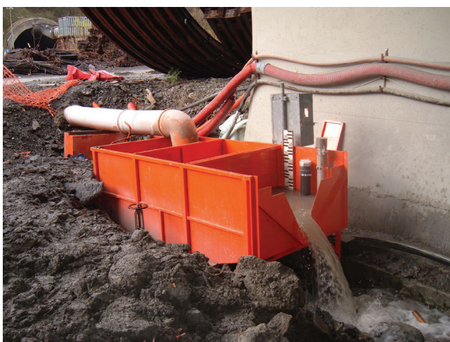
Fig. 11 - Stazione di misura della portata drenata all'imbocco di una galleria in costruzione.
